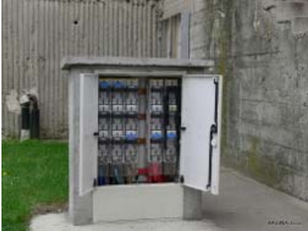
Sl. Izgled niskonaponskog razvodnog ormara sa 6 izvoda »NKRO6«
